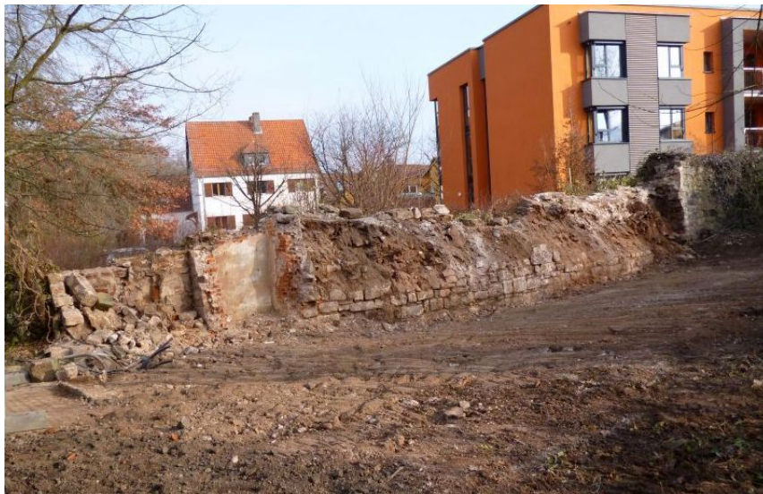
Abb. 2: Das auf ca. 25m stark beschädigte und um ca. 1,5m an Höhe abgetragene Teilstück der Stadtmauer.
